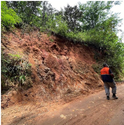
Figura 1: Ocorrência A, deslizamento planar a montante da Rua das Margaridas em frente ao no 297
