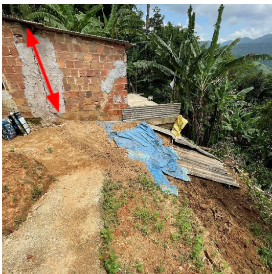
Figura 5: Ocorrência B, deslizamento planar a jusante da casa de no 526, em detalhe (seta vermelha) a grande rachadura da cozinha
