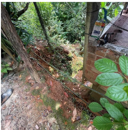
Figura 3: Ruptura ao lado da casa de no 297
