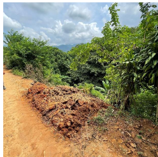
Figura 4: Deslizamento a jusante da Rua das Margaridas, entre as casas no 297 e no 526
