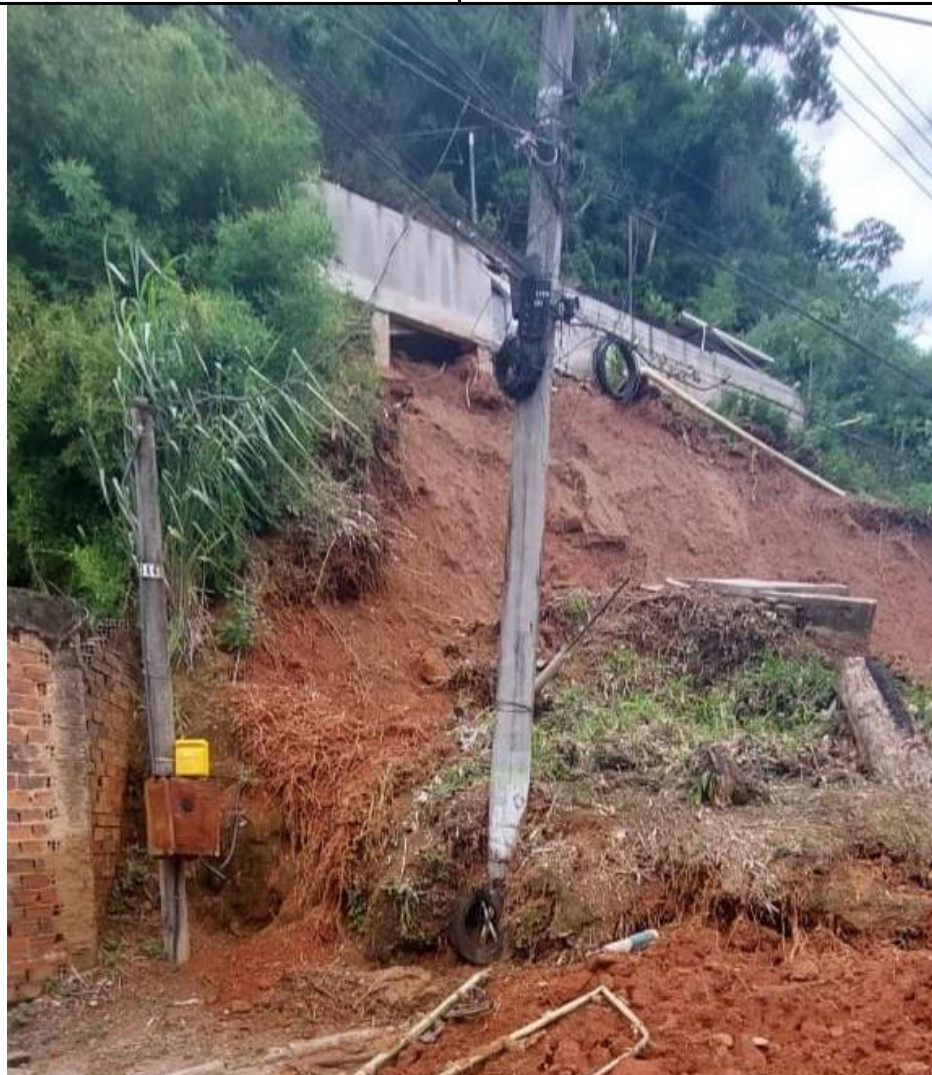
Figuras 6: Residência afetada pelo deslizamento
