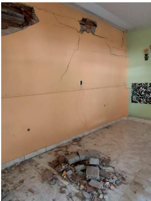
Figuras 2: Quarto parcialmente destruído
