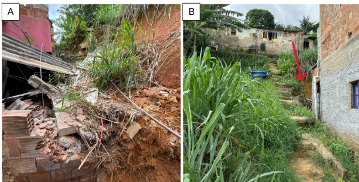
Figura 2. (A) Cômodo parcialmente colapsado. (B) Casa nº 27 fundos, teve sua escada de acesso atingida pelo movimento de massa como indicado pela seta vermelha.
