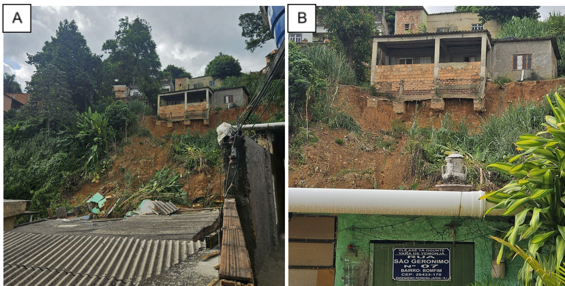
Figura 4. (A) Fundos da casa nº7 atingida por material mobilizado. (B) Casa localizada acima dos fundos da casa nº 7, com crista do movimento na altura do patamar e, exposição da fundação.
