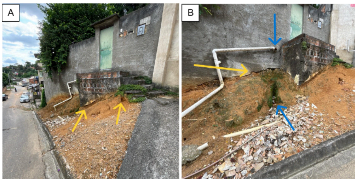
Figura 3. (A) Rachaduras na base da entrada. (B) Indicado pela seta azul, um cano direcionando água para o talude, e com feições erosivas marcadas.
