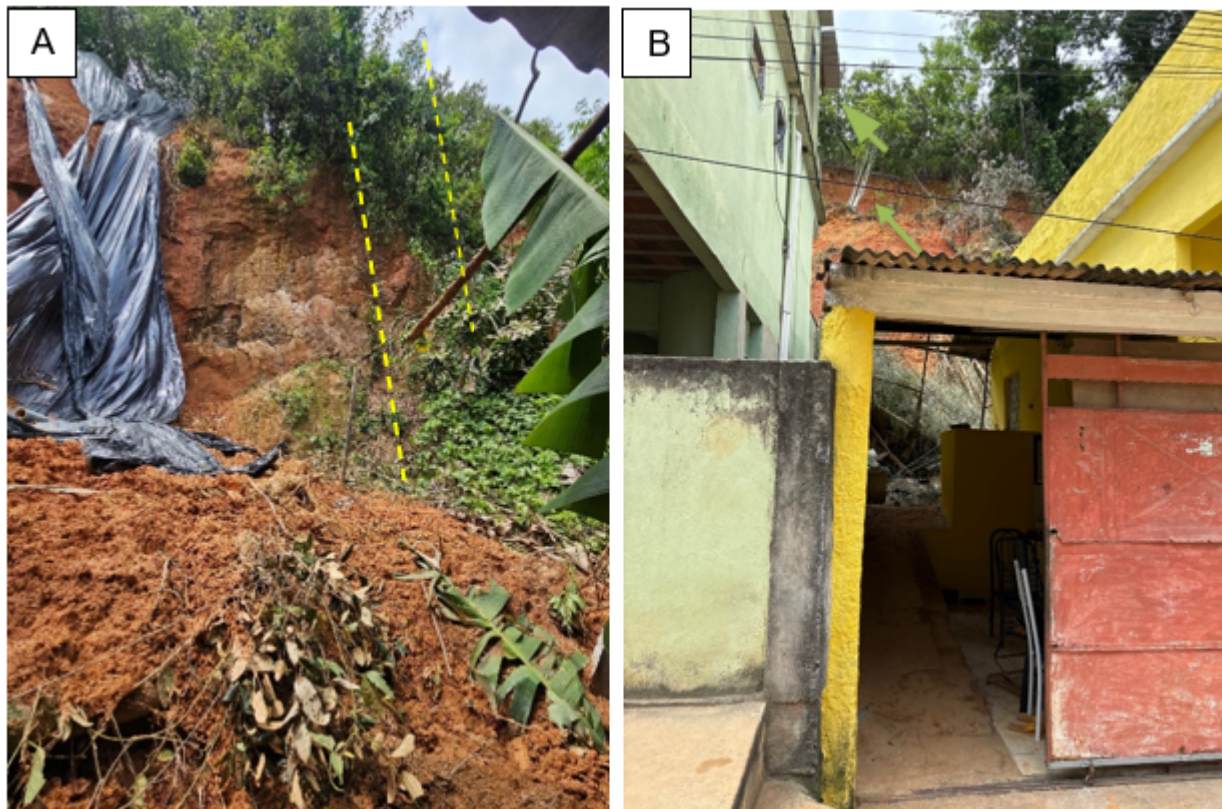
Figura 04: A) Cicatriz de deslizamento, demonstrando rocha fraturada e área de ruptura (linha pontilhada) sugerindo instabilidade do terreno; B) Visada frontal da cicatriz de deslizamento através de imóvel, podendo ser observada a movimentação de elemento arbóreo com sentido de tombamento rente a vertente (seta verde).
