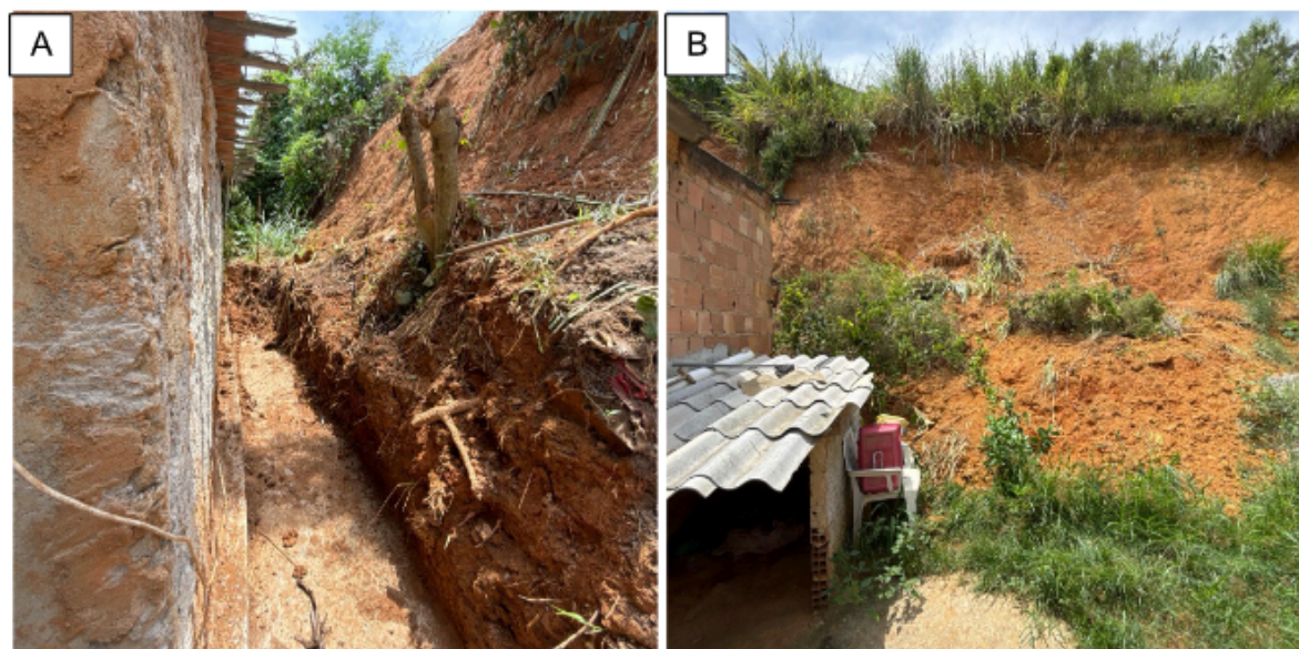
Figura 2. (A) Fundos da casa 249, moradores estavam escavando para acessar o poço artesiano. (B) Lateral da casa 248, com mais de 1,5m de material mobilizado nos fundos da residência.
