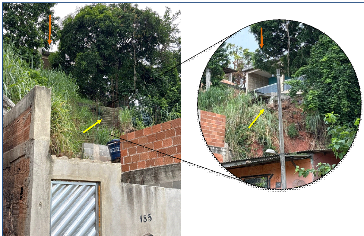
Figura 02: Entrada do imóvel nº 185, demonstrando escada de acesso (seta amarela) a edificação (seta laranja) localizada na porção superior do talude. Em detalhe, a partir de visada lateral, é possível observar descalçamento da escada de acesso decorrente do movimento de massa deflagrado no local, evidenciado pela cicatriz sob essa.
