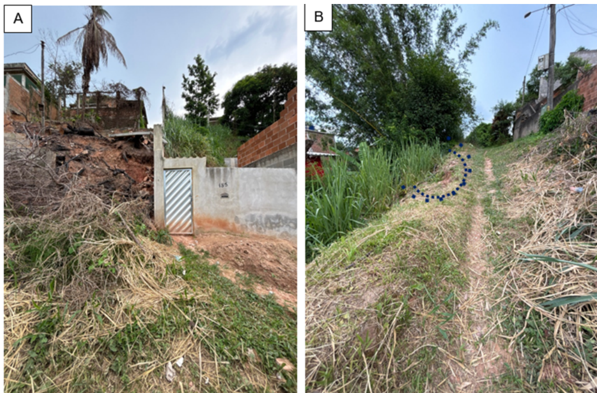
Figura 03: A) Deslizamento em talude sob ruínas, com desabamento parcial de muro limítrofe; B) Identificação de perda de material na crista do talude (linha pontilhada) que funciona como caminho de acesso aos imóveis localizados na porção superior da via.
