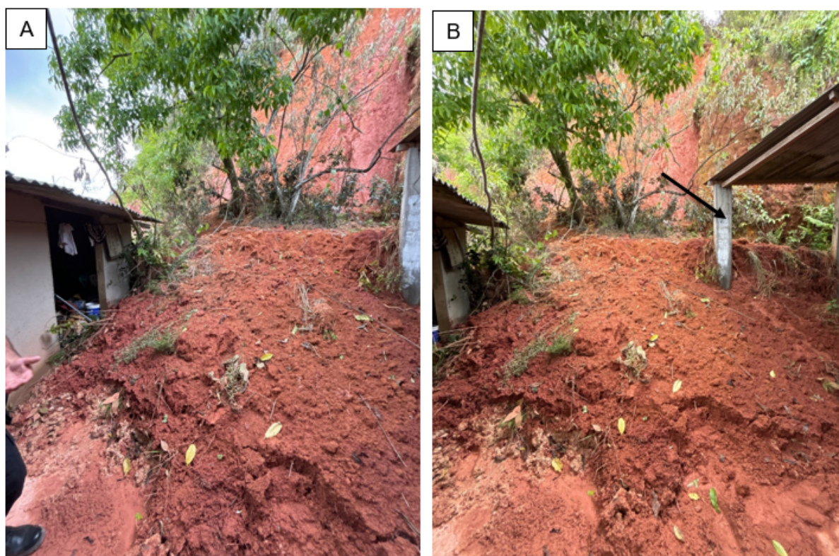
Figura 02: A) Área de atingimento do imóvel pelo material mobilizado. B) Área de alcance do material mobilizado indo além das edificações e ultrapassando a mureta da varanda de uma delas (seta indicativa).
