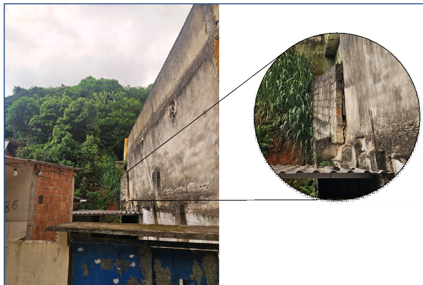
Figura 02: Visada frontal dos imóveis nº 174 e 186, mostrando cicatriz de deslizamento ao fundo deste último, com destaque para patologia estrutural causada em muro limítrofe após deflagração de movimento.
