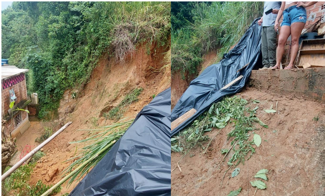
Figuras 6 e 7: Deslizamento planar impactando a residência 289 e 305.
