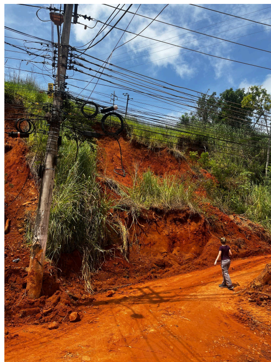
Figura 2: Vertente lateral da cicatriz, localizada na Rua Maria Trindade Resende. Grande volume de material mobilizado.
