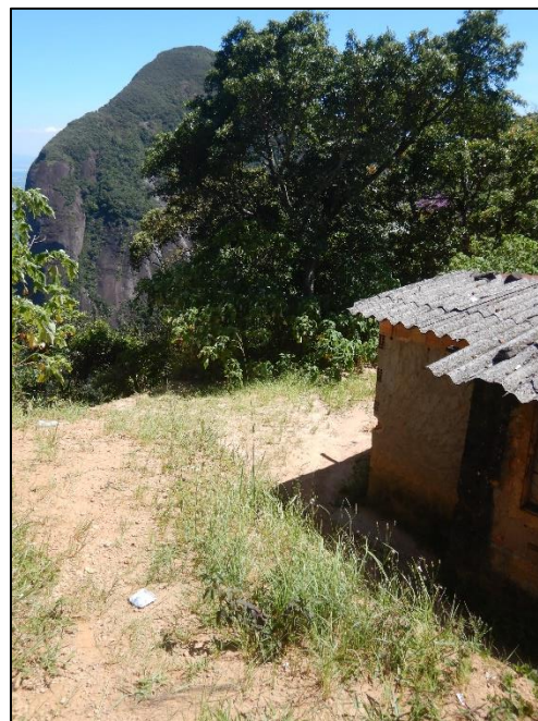
Figura 3. Casa próxima da crista de deslizamento.
