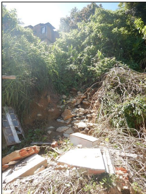
Figura 4. Destruição de construção.
