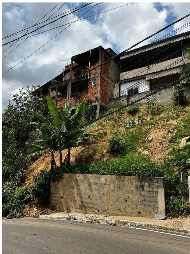
Figura 5: Visada lateral da cicatriz 2. Na base da encosta há um muro de contenção com drenos. Há uma bananeira à meia encosta, que pode contribuir para a instabilidade do talude.
