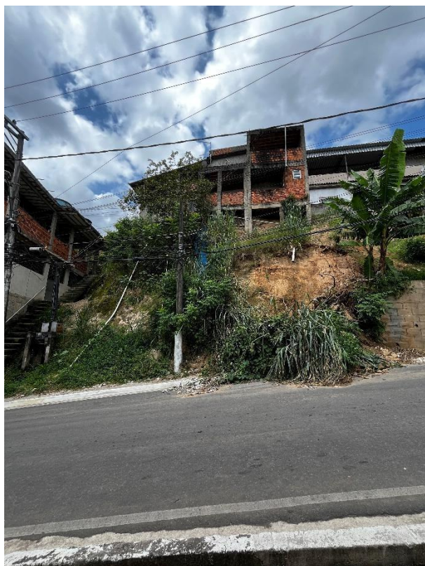
Figura 3: Visada frontal da cicatriz 2 na rua Humberto Ferraz. À montante da cicatriz estão as 2 residências englobadas no polígono de risco dessa ocorrência.
