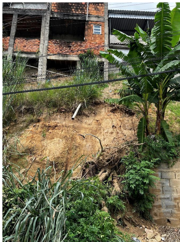
Figura 4: Observar o encanamento rompido no centro da cicatriz de deslizamento. Fato que pode contribuir para o avanço do processo pelo aumento da umidade local.
