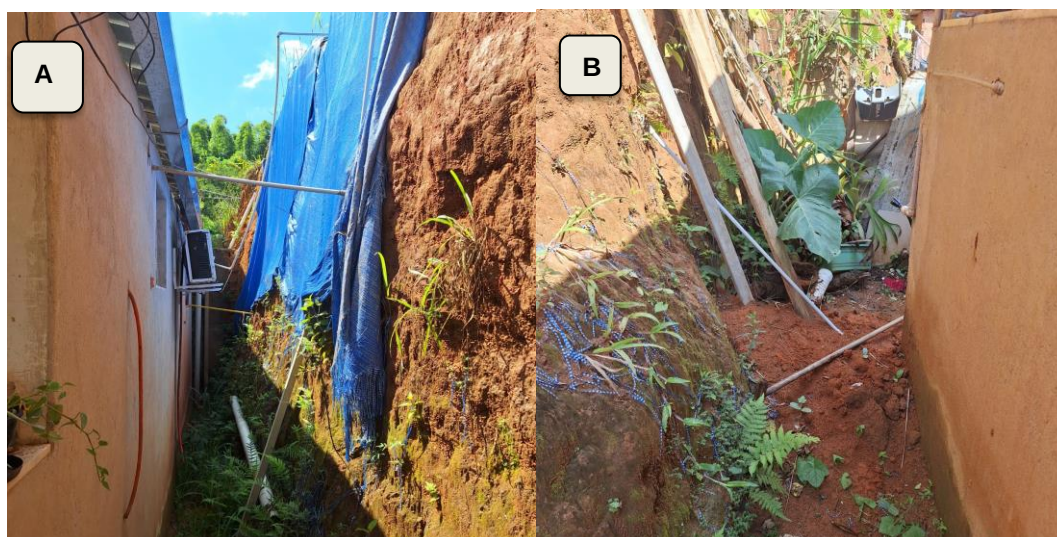
Figuras A e B: Talude posicionado nos fundos da residência protegido parcialmente por uma lona e material mobilizado nas últimas chuvas.
