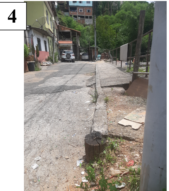
Trincas e desalinhamento no meio-fio na rua Rio Grande do Sul.
