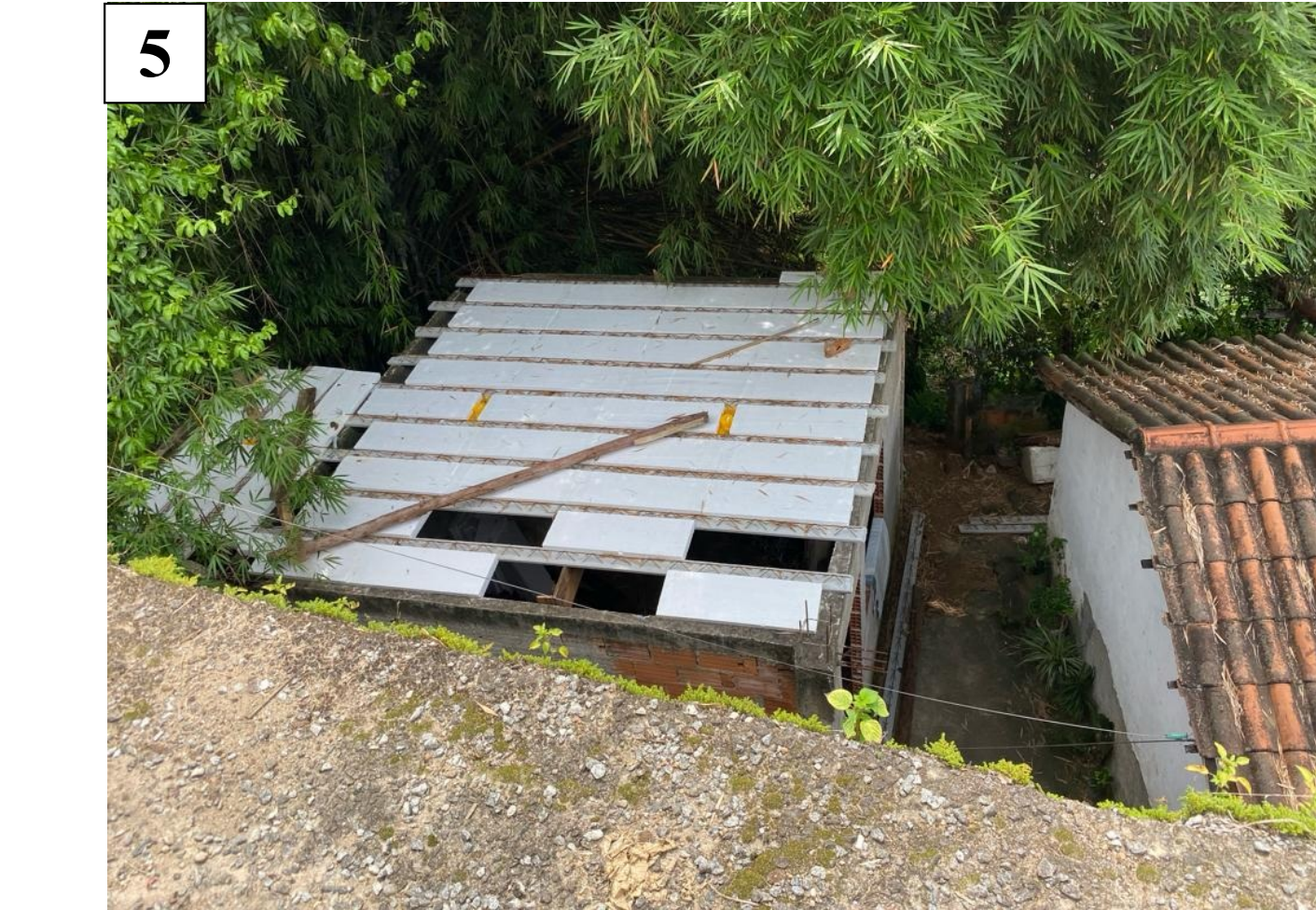
Casa em fase de construção dentro da drenagem natural. A construção está muito próxima ao talude de corte (~1 m), assim como do topo do talude natural (1,5 m) voltado para a linha de drenagem.
