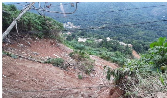
Figura 4: deslizamento planar e casas em risco próximo ao talude.
