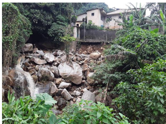
Figura 5: Residências localizadas junto a drenagem encaixada, nesta observam-se os rastros da enxurrada, com presença de blocos de rocha e com exposição de solo devido ao processo erosivo.
