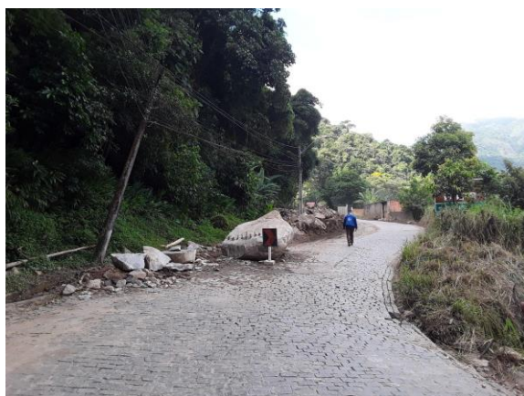
Figura 6: Blocos de rocha mobilizados em processo de movimento de massa que atingiu área adjacente à residências.
