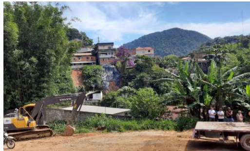
Figura 6: Cicatriz de deslizamento na base das residências
