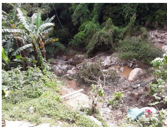
Figura 4: Tubulação danificada ao longo do talude.
