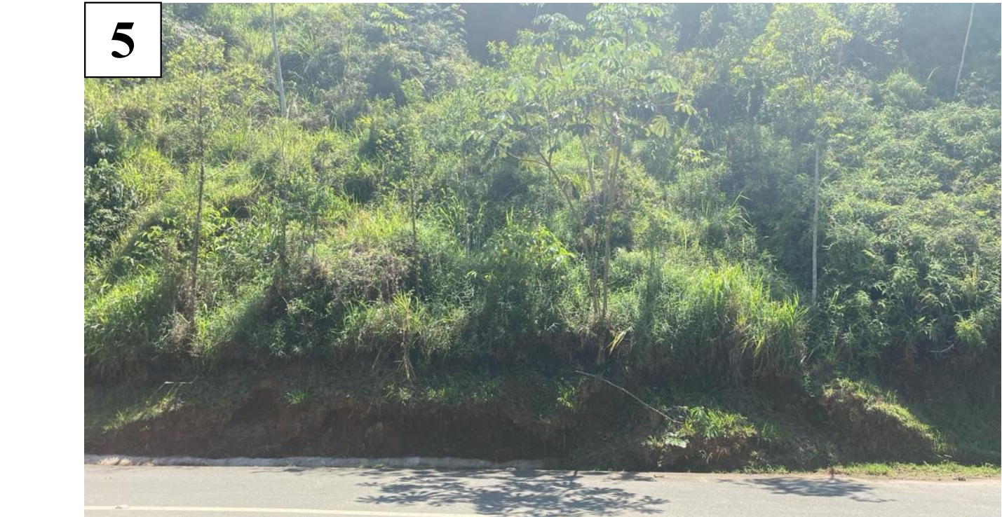
Observar a extensão da massa de solo mobilizada da parte superior da encosta, agora já estabilizada na lateral da via.
