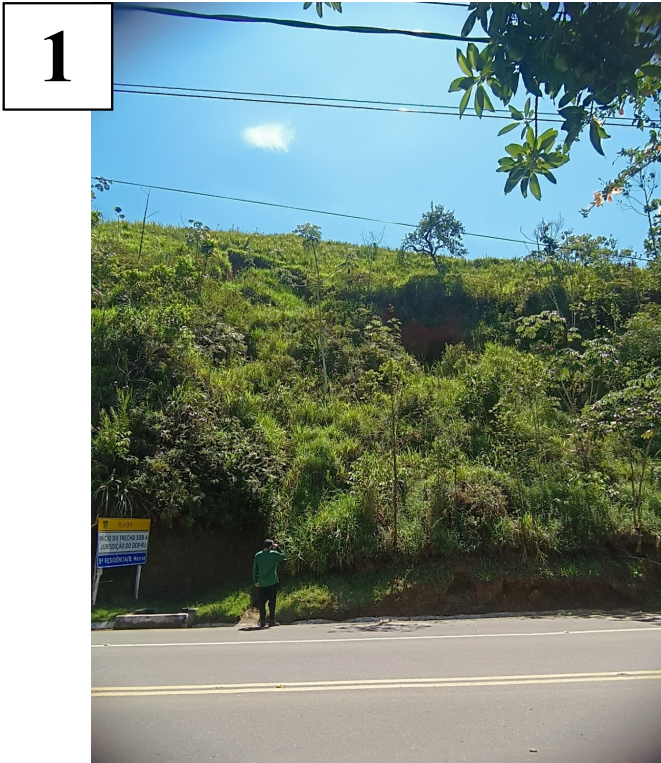
Visada panorâmica do local do movimento de massa. Na parte superior da encosta observa-se a cicatriz do deslizamento pretérito e na lateral esquerda há a escada hidráulica, com vegetação superposta.
