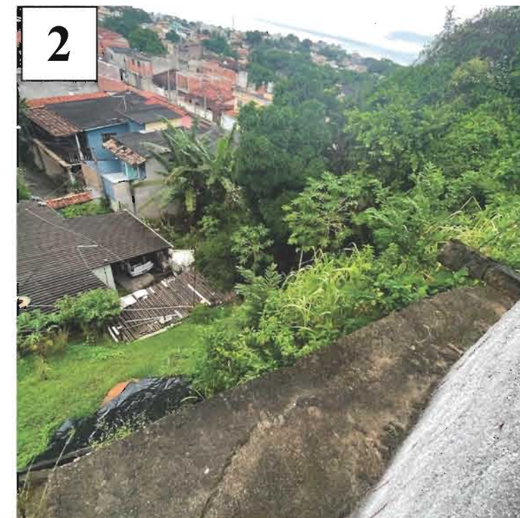
Destaque para vegetação de alto porte no talude a jusante das residências vizinhas.
