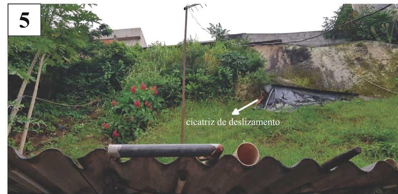
Encosta com obra de contenção sem drenos e presença de cicatriz de deslizamento.
