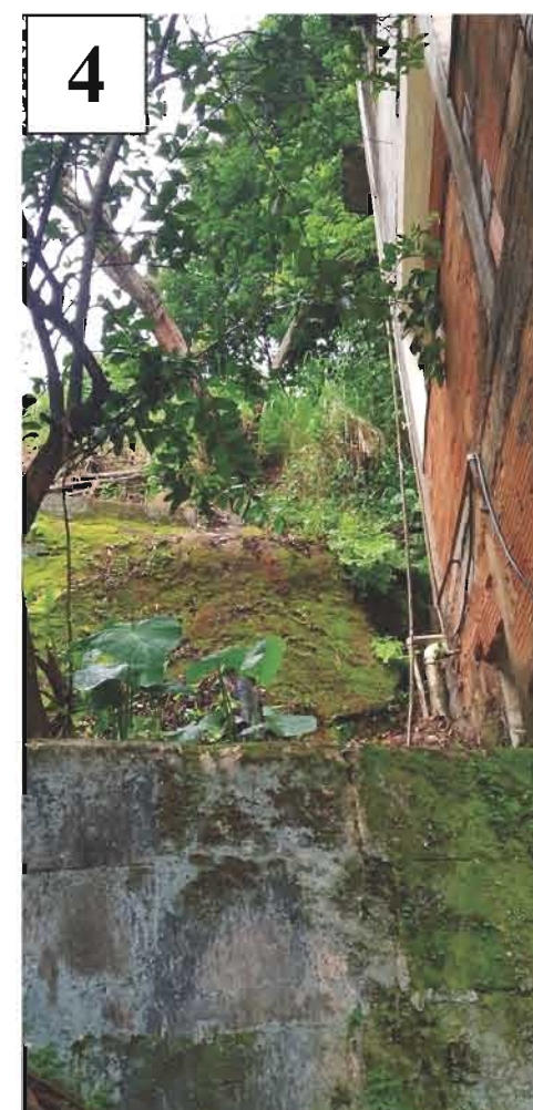
Presença de muro de alvenaria na base do talude e intervenção de engenharia realizada sem dreno a montante. Canos de água e esgoto expostos.
