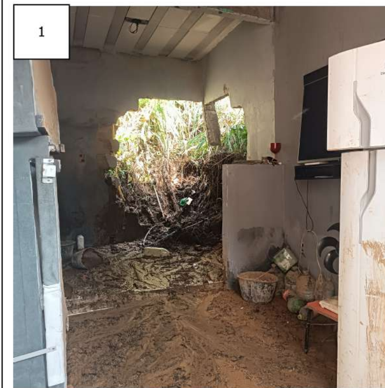
Lote 35, quadra 5. Fundos da moradia destruído pelo material deslocado do deslizamento.
