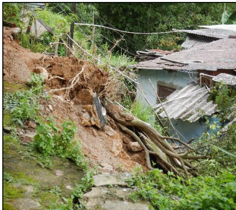
Figura 8. Moradia atingida por deslizamento.
