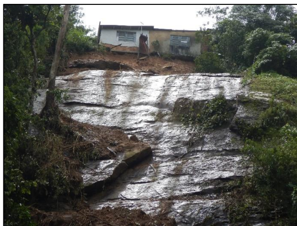
Figura 19. Construção localizada no topo da cicatriz e com risco muito alto.
