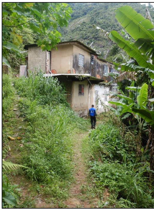
Figura 7. Construções afetadas pelo deslizamento.
