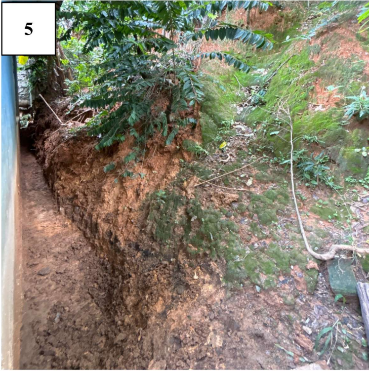
Fundos da casa 714, talude escavado pelo morador após o evento.
