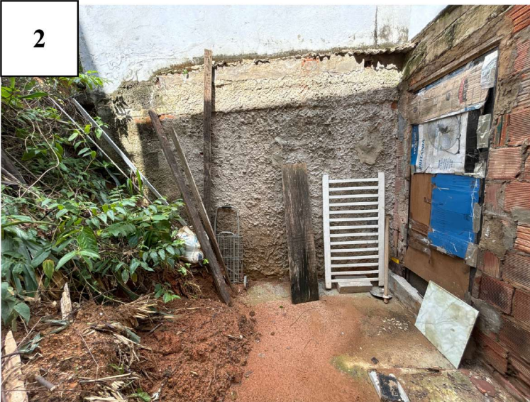
Lateral direita da residência 726, com área de serviço destruída. Morador já retirou muito material mobilizado.
