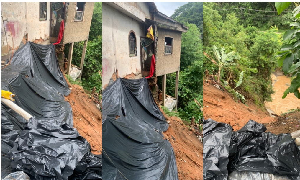
Figura 3 – Escorregamento de talude na parte posterior da residência atingindo fundações da lateral esquerda.
