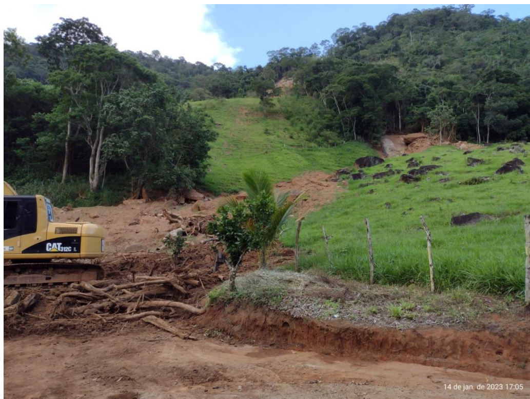
Figura 2: Vista do talude que sofreu o escorregamento.
