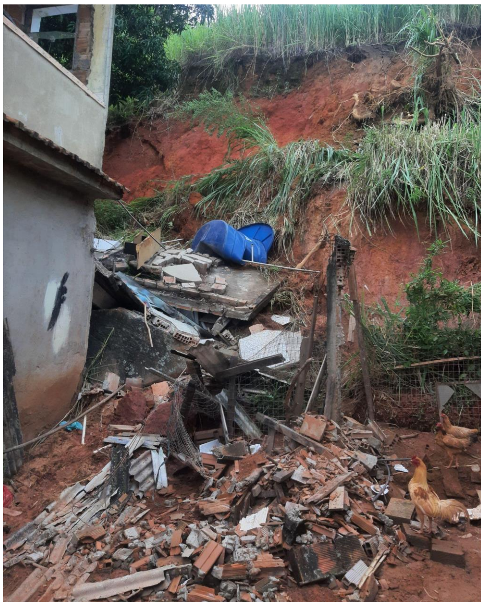
Figura 1: Movimento complexo, com identificação de feições geológicas geotécnicas de alta complexidade.
