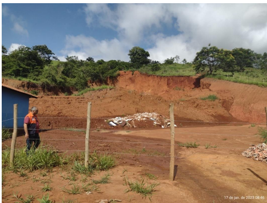
Figura 2: Vista do talude que sofreu o escorregamento.
