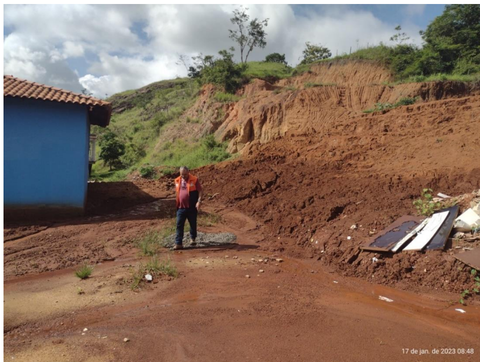
Figura 5: Lateral esquerda do talude , mostrando um processo erosivo intenso.
