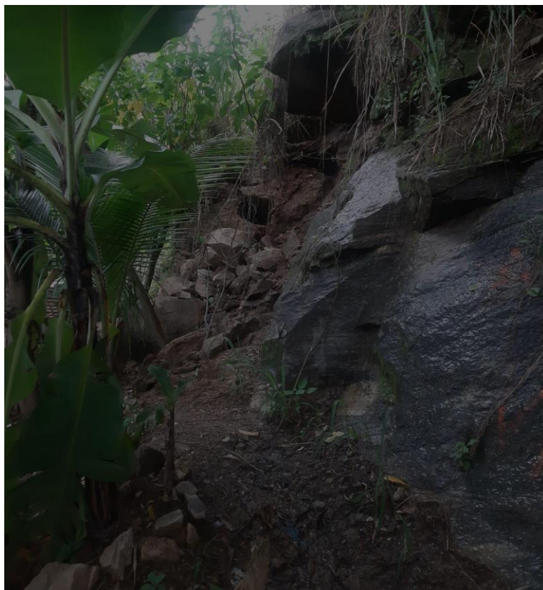
Figura 3: Queda de blocos ao lado da moradia s/n. Afloramento com percolação de água.
