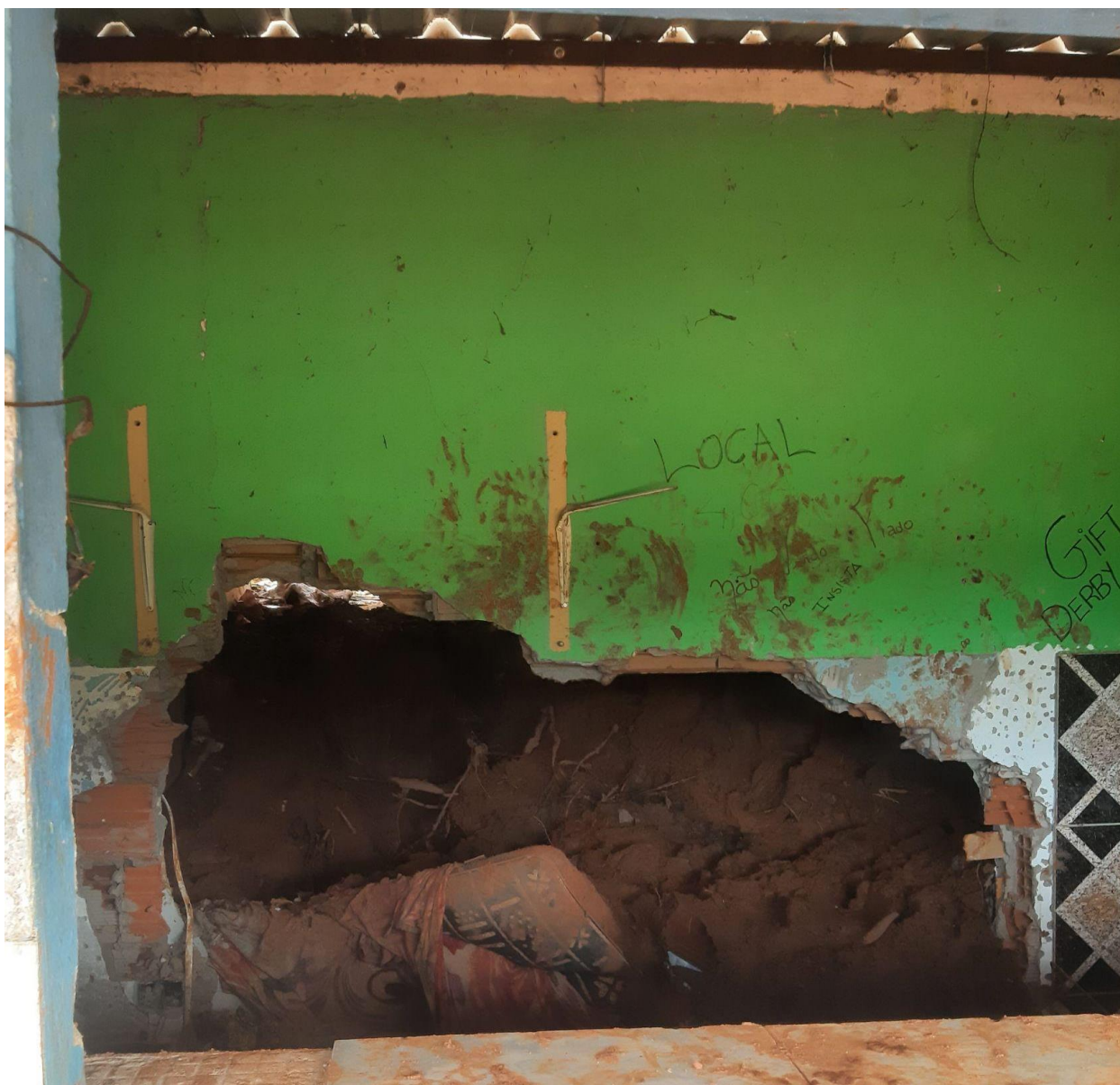
Figura 2: Parede frontal do prédio atingido pelo deslizamento onde houve o óbito.
