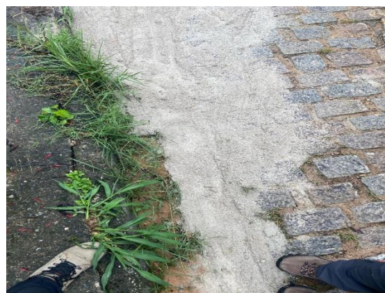
Figura 4: Trincas cobertas com concreto.
