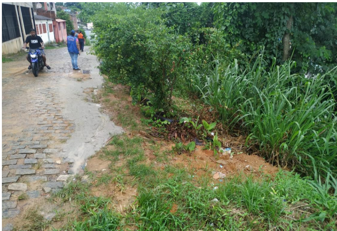
Figura 1: Talude localizado a jusante da Rua do Arapoti, Engenheiro Pedreira.
