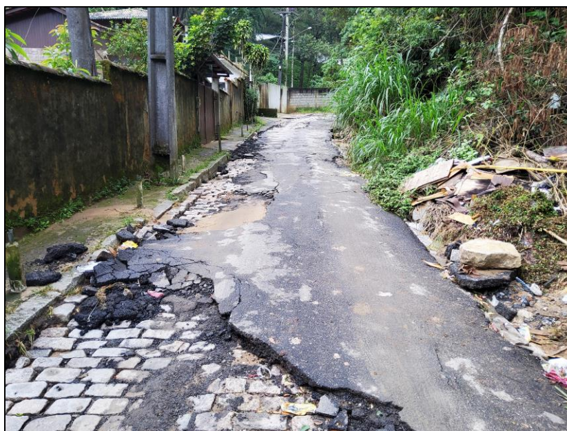
Figura 7. Rua Engenheiro José lima Filho danificada por conta da ação da água. Nenhuma casa atingida.
