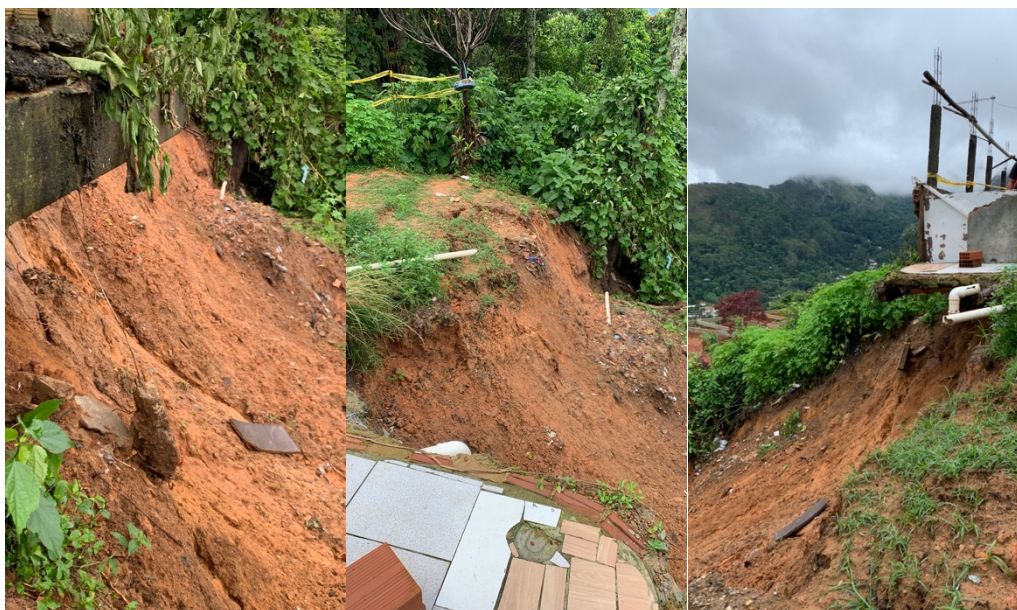
Figura 3 – Talude após escorregamento de massa com caminhos de drenagem natural
