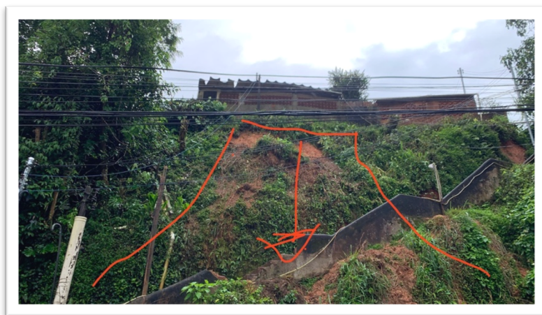
Figura 2 - Projeção ilustrativa do caminho preferencial do escorregamento do talude, comprometendo acesso à residência e tráfego na rua à jusante da residência.
