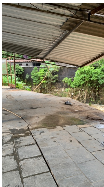
Figura 4 – Laje de piso do estacionamento do posto de combustível / lava jato apresentando rachaduras que indicam movimentação da estrutura civil.
