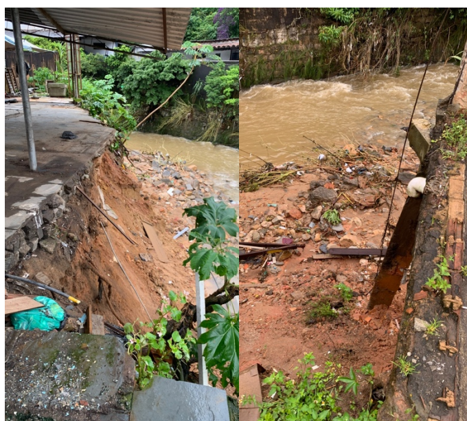
Figura 3 – Solapamento (escorregamento) de base do talude
