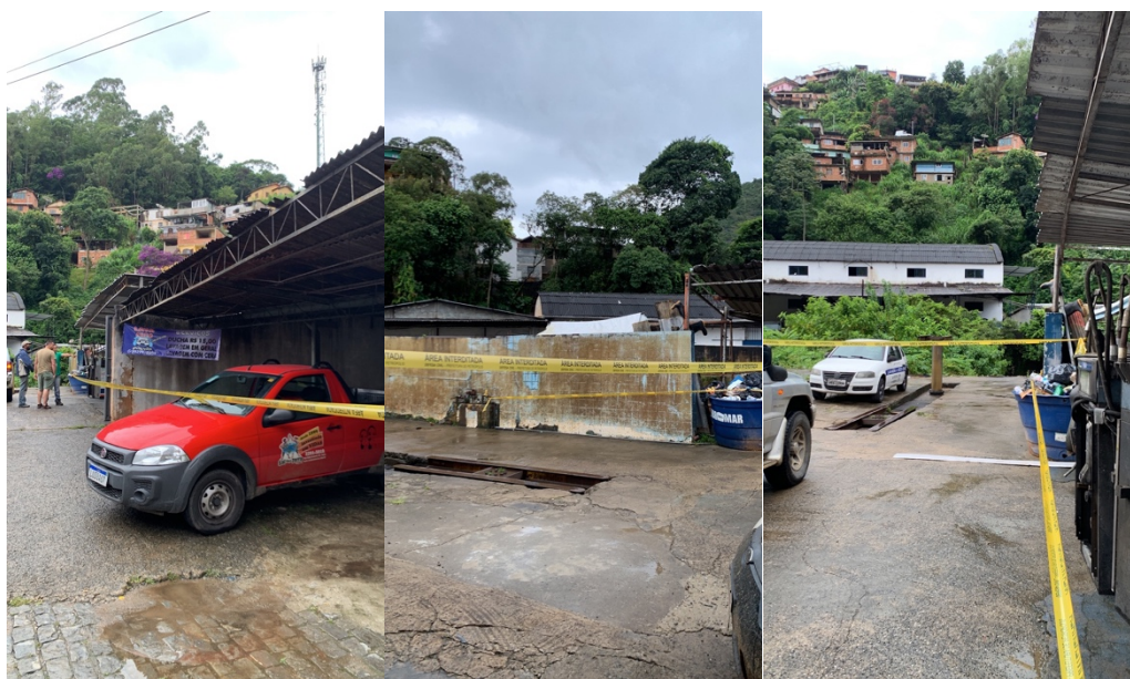
Figura 5 - Interdição parcial da área atingida
