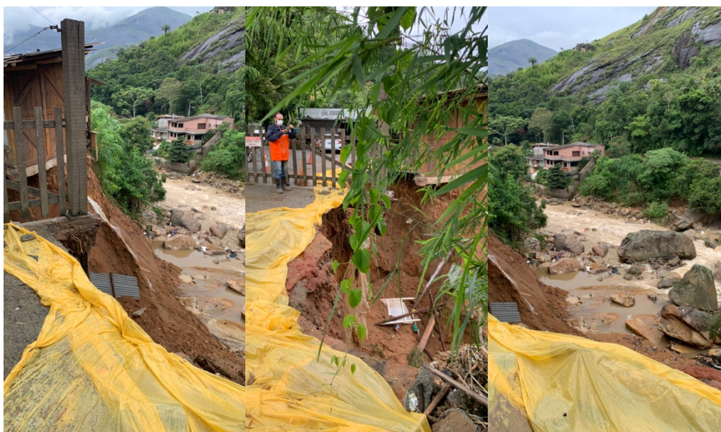
Figura 3 – Solapamento de talude após aumento da vazão e velocidade de escoamento do Rio Piabanha
