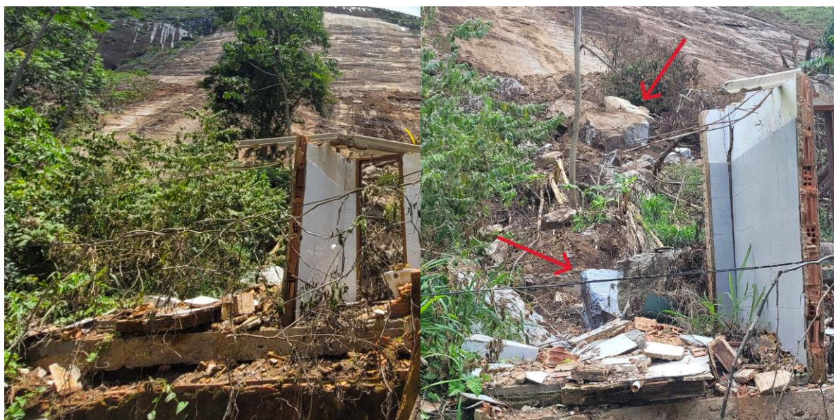
Figura 2: Situação da base da encosta em 25/01/2024 (A) e 05/02/2024 (B), as setas vermelhas destacam material remobilizado no intervalo de 10 dias.
