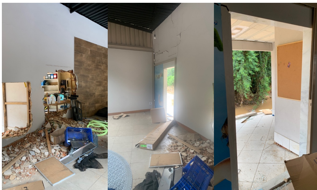
Figura 5 - Trincas, rachaduras e queda de alvenaria no interior do estabelecimento
