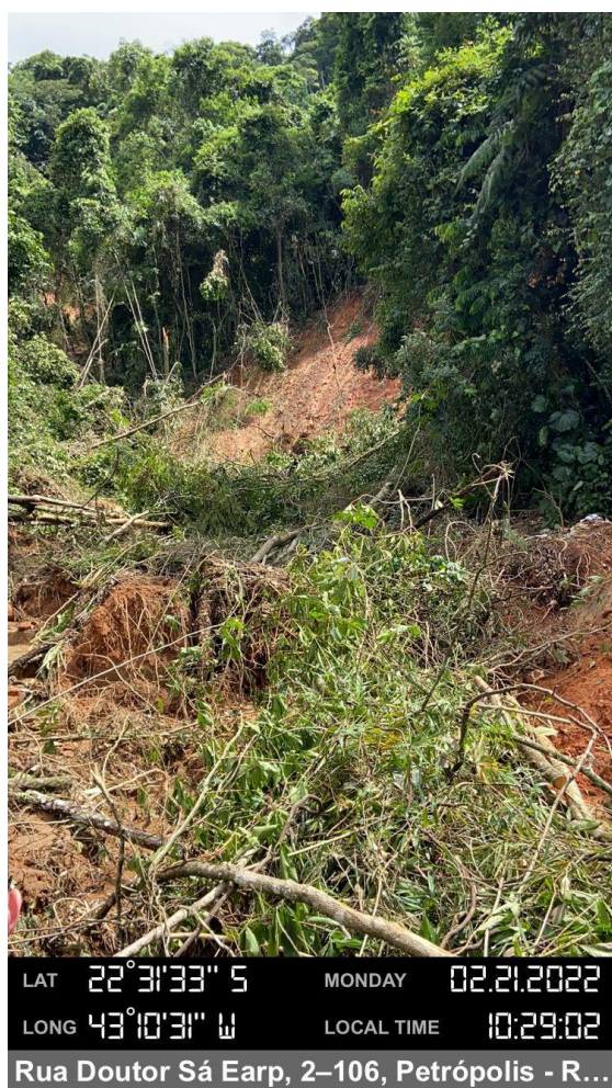
Foto 5: Local do deslizamento
