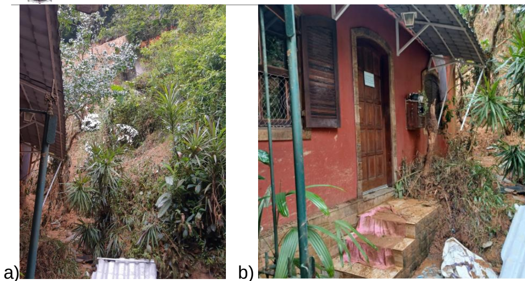
Figura 2. Vista frontal inferior do talude que deslizou e atingiu a casa.
