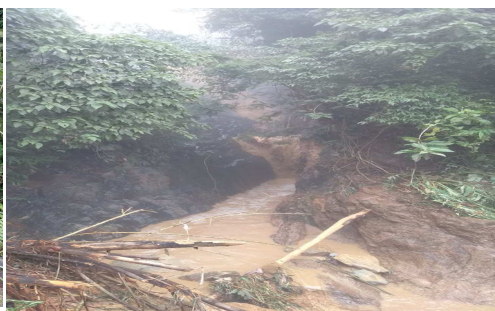
Foto 4 – Fluxo intenso de água à montante da via.
