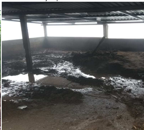
Foto 10 – Garagem de residência a margem da via após inundação.
