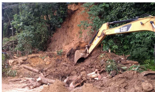
Foto 1 – Presença de maquinário pesado na área de risco.
