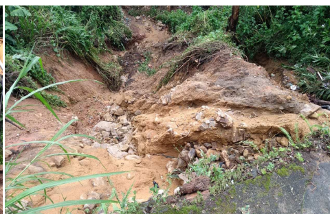
Foto 2 – Deslizamento de Material à montante da via.
