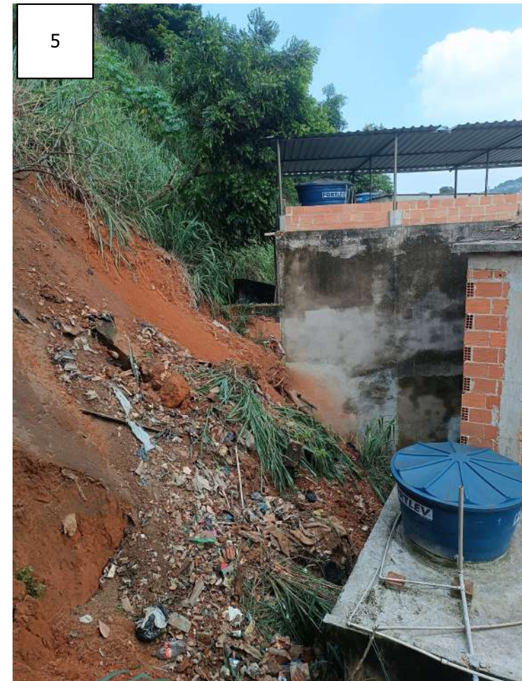
Atingimento em residência a jusante da travessa Itacaré.
