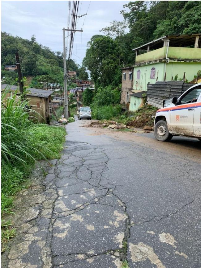
Figura 03. Afundamento de via bem demarcado indicando movimentação do solo, evidenciando possíveis novos deslizamentos nos imóveis a jusante da via.
