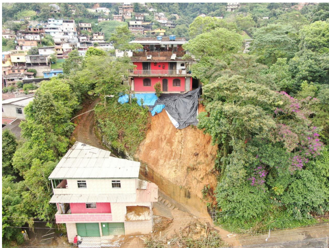
Figura 01. Deslizamento na Rua Rio de Janeiro a jusante do imóvel, atingindo parcialmente uma residência, causando danos estruturais e obstruindo a via. Sem vítimas.
