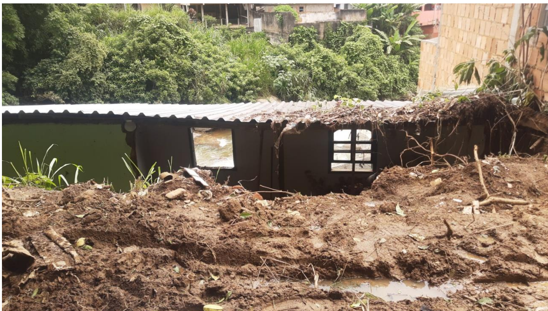
Figura 7. Imagem da frente da casa danificada, com sua alvenaria destruída.
