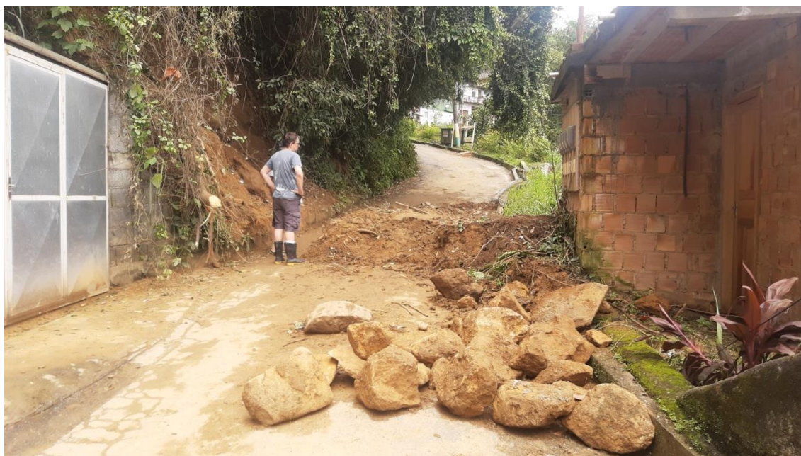
Figura 6. Imagem mostrando a casa danificada e o talude que cedeu, atingindo-a.
