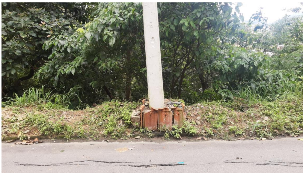
Figura 4. Poste na beira da rua, ao lado do talude.
