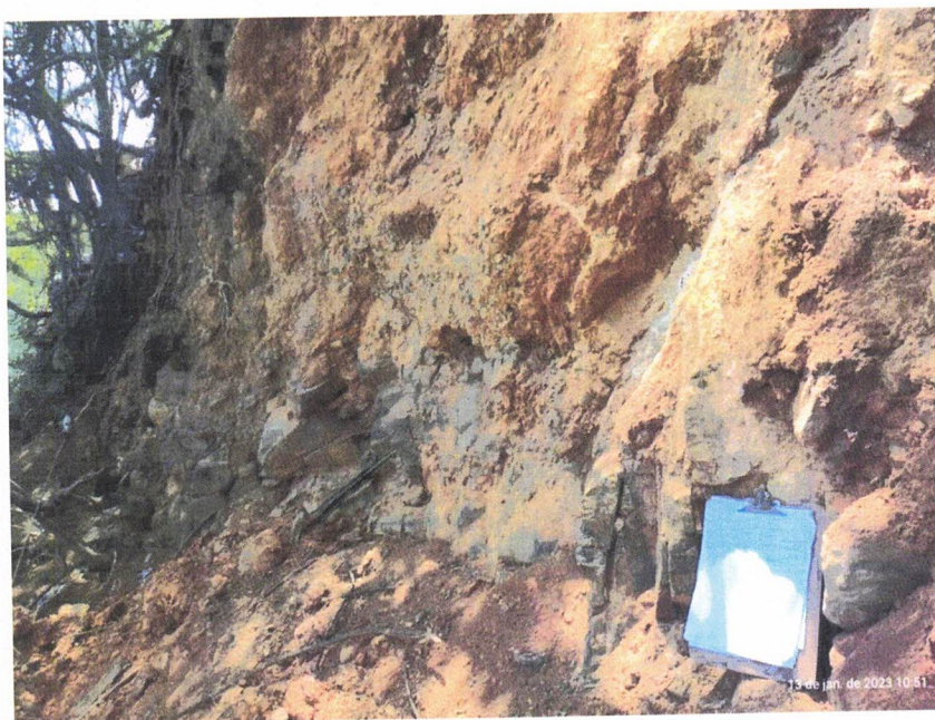
Foto 3 – Outro trecho do talude que após o escorregamento deixou amostra a rocha básica com sistemas de fraturas uma sub-vertical e outra com mergulho para NE
