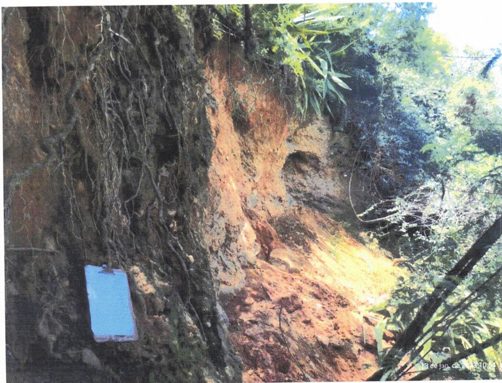
Foto 2 – Vista do trecho escorregado, as cavidades presentes são em função escavações feitas por moradores de rua que vivem nas proximidades.
