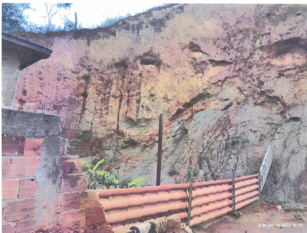
Foto 2 – Perfil do talude onde são identificados os horizontes de solo residual maduro, jovem e rocha alterada, cicatriz de escorregamento e feições erosivas lineares.
