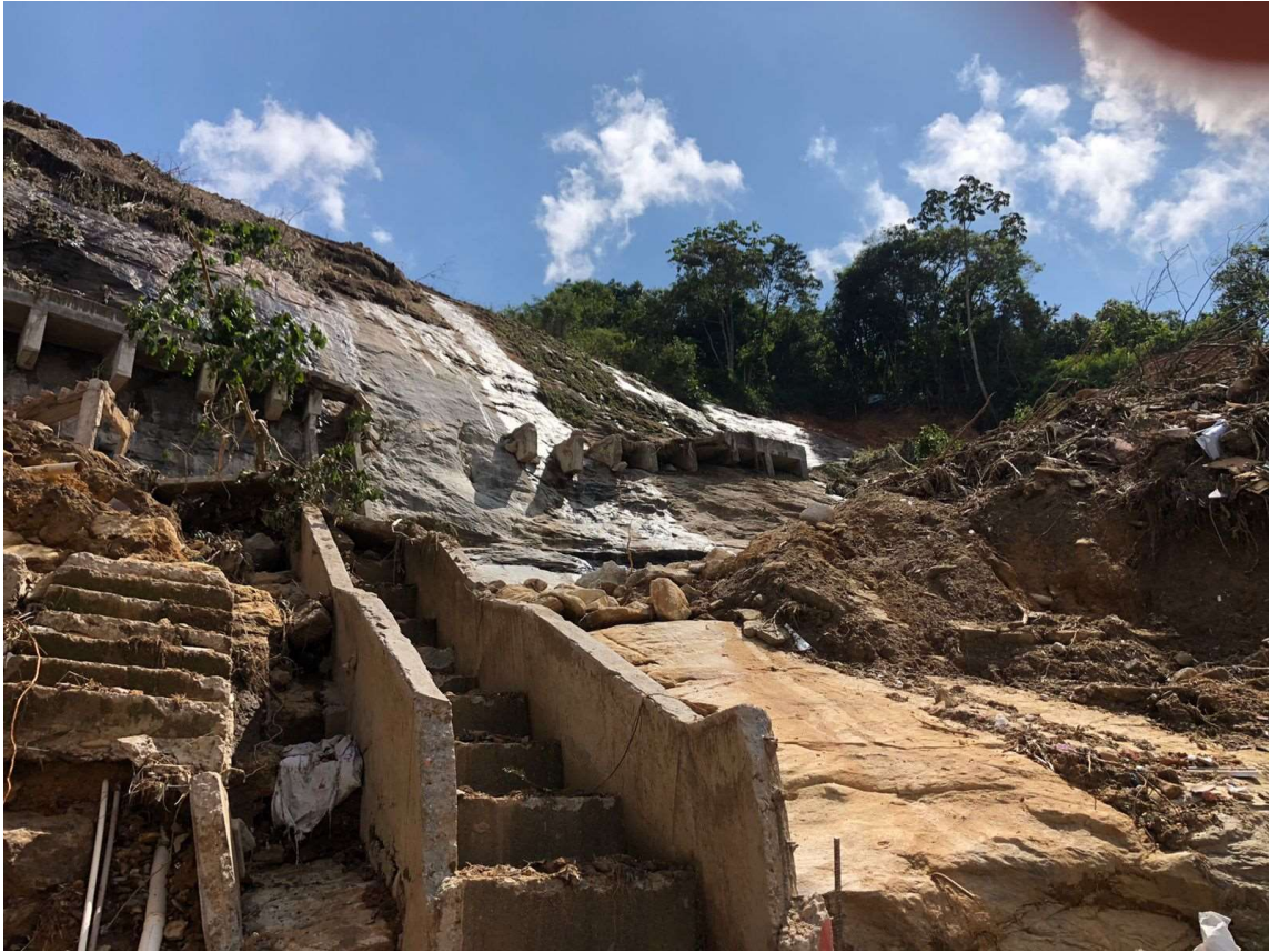
Figura 6: Dispositivos de drenagem avariados
