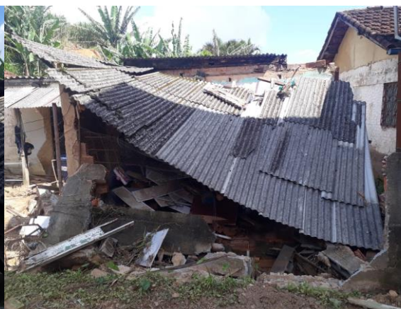
Casa com dano total nas proximidades do nº 495.
