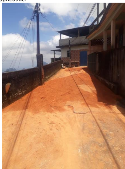
Final da Rua Manuel Antônio da Costa, que apresenta riscos quanto a integridade.
