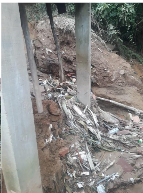
Parte da base de uma das casas atingida por deslizamento.
