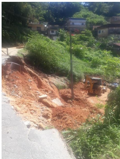
Talude que deslizou, com destruição parcial da estrada.
