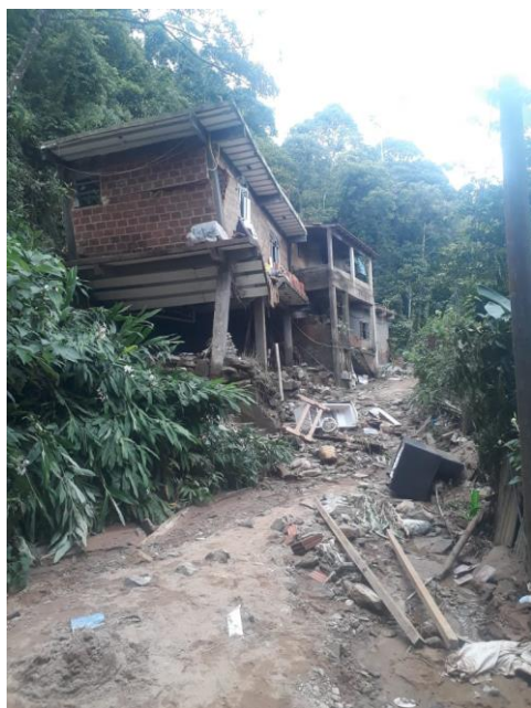
Casas no nº 148, a primeira com dano total e a do lado com dano parcial.
