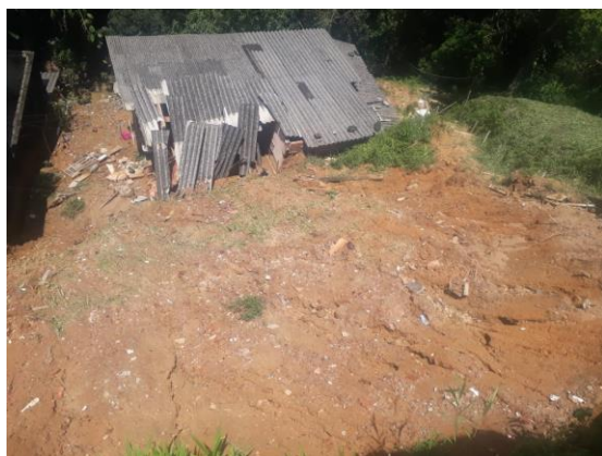
Casa do final da rua, e abaixo dela, com destruição total.
