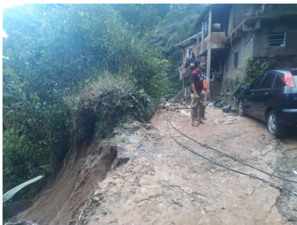
Talude onde houve o deslizamento atingindo as casas abaixo.
