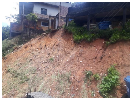
Talude onde houve deslizamento que gerou destruição total de propriedade.
