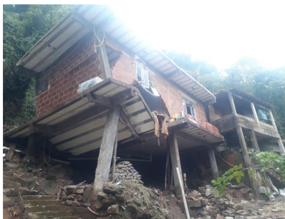
Casa do nº 148, com dano total.
