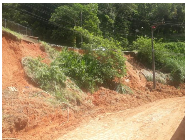
Talude que deslizou para a Rua Manuel Antônio da Costa.
