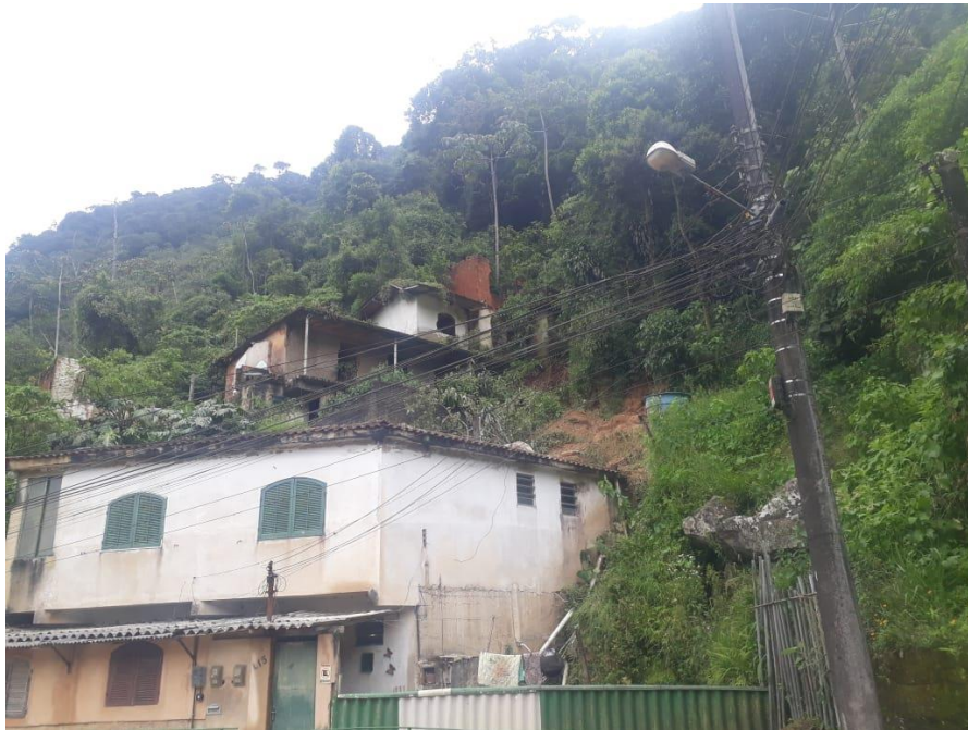
Casa onde ocorreu deslizamento nos fundos. Risco geológico muito alto.
