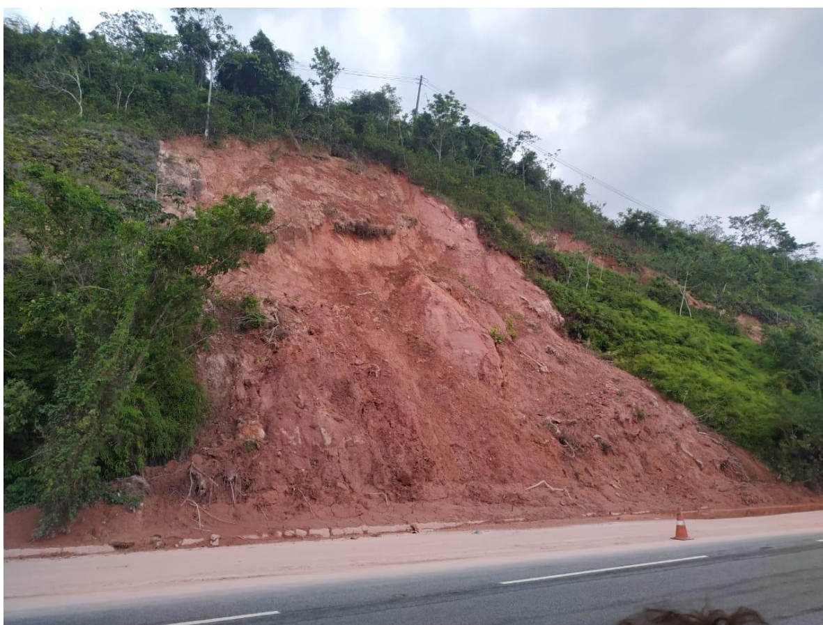
Figura 1: Encosta na Rodovia Amaral Peixoto com interdição parcial da via.
