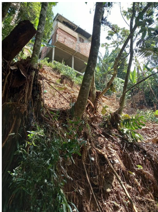
Foto 3 - Deslizamento a jusante do imóvel;
