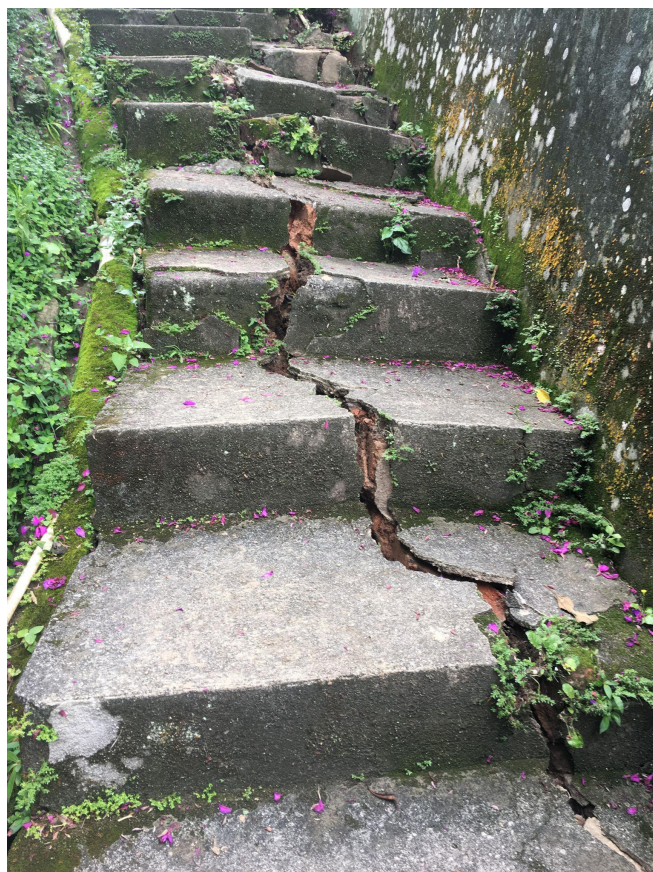
Fissuras na escada
