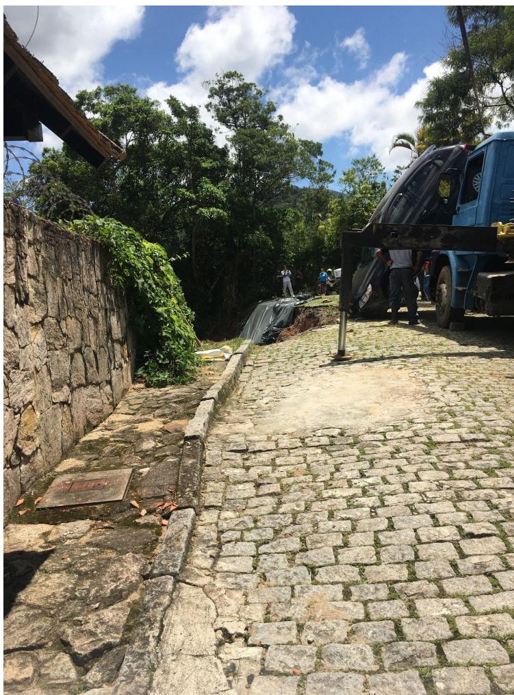
Um pedaço da Rua Domingos Andrade Bastos cedeu
