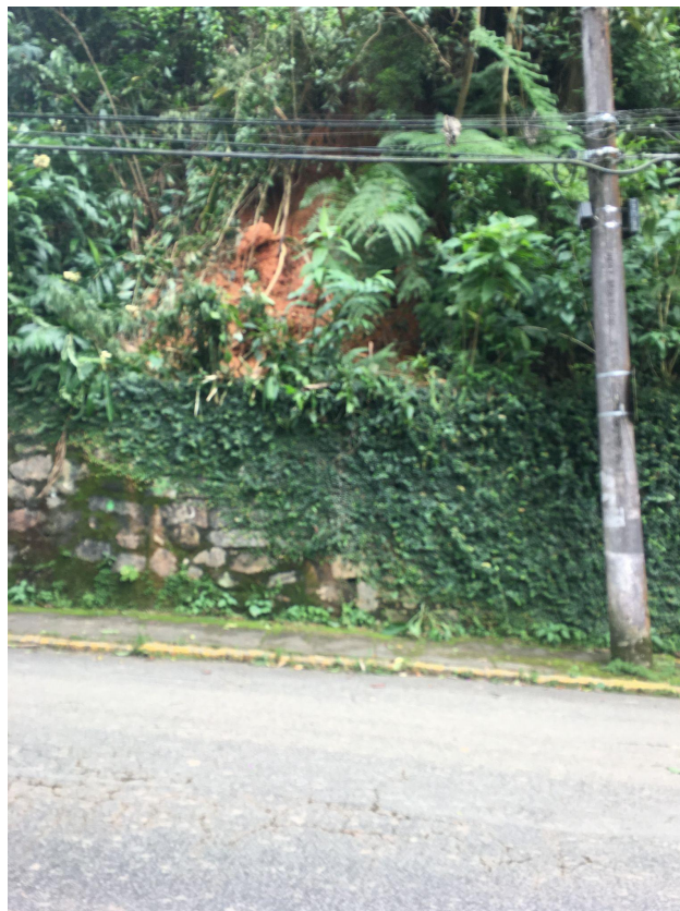
Deslizamento na Rua Kopke, não oferecendo risco a residências
