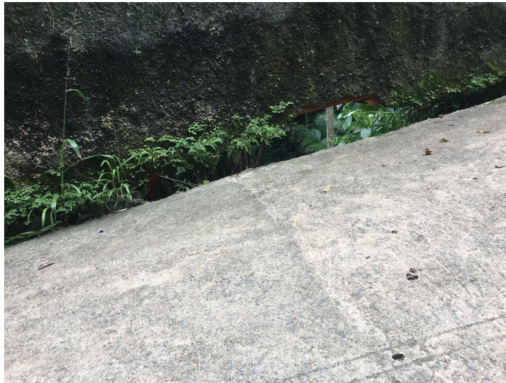
Fissura entre a calçada e o muro de uma residência
