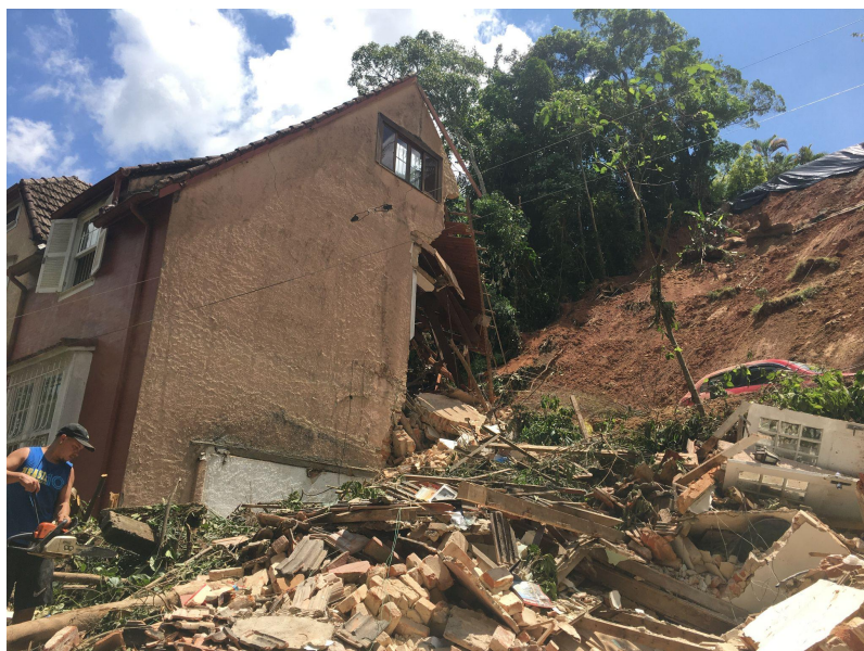
Deslizamento destruiu parte do imóvel à Rua Padre Siqueira, nº 183
