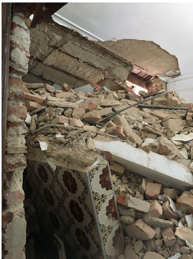
Escombros dentro do imóvel da Rua Padre Siqueira
