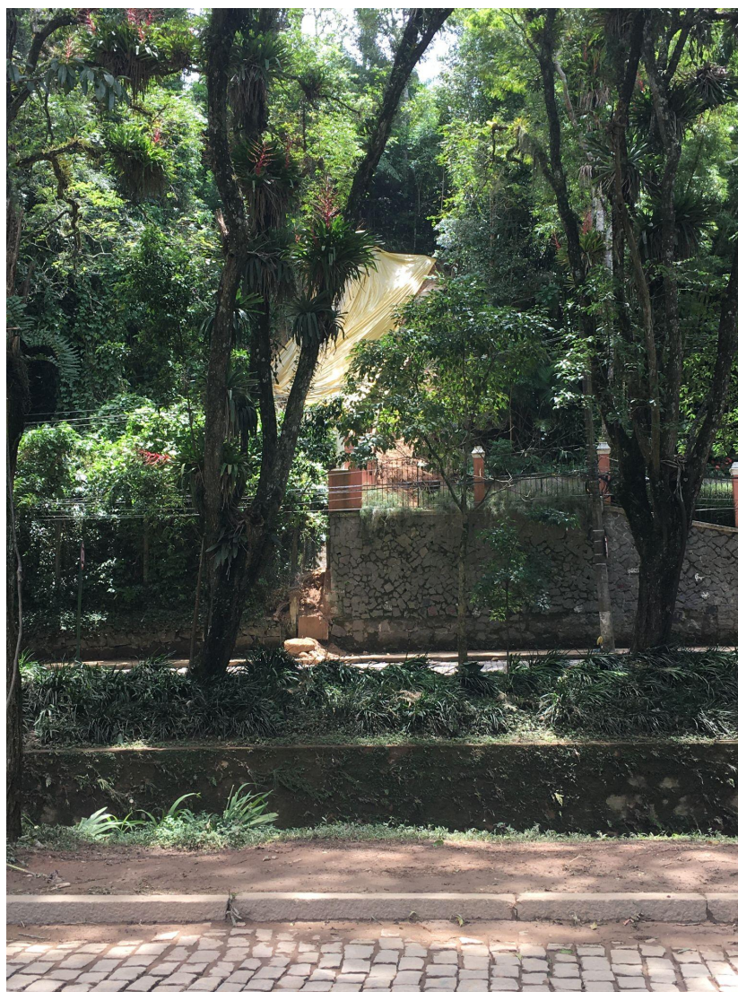
Deslizamento coberto por lona, observado à partir da Av. Piabanha
