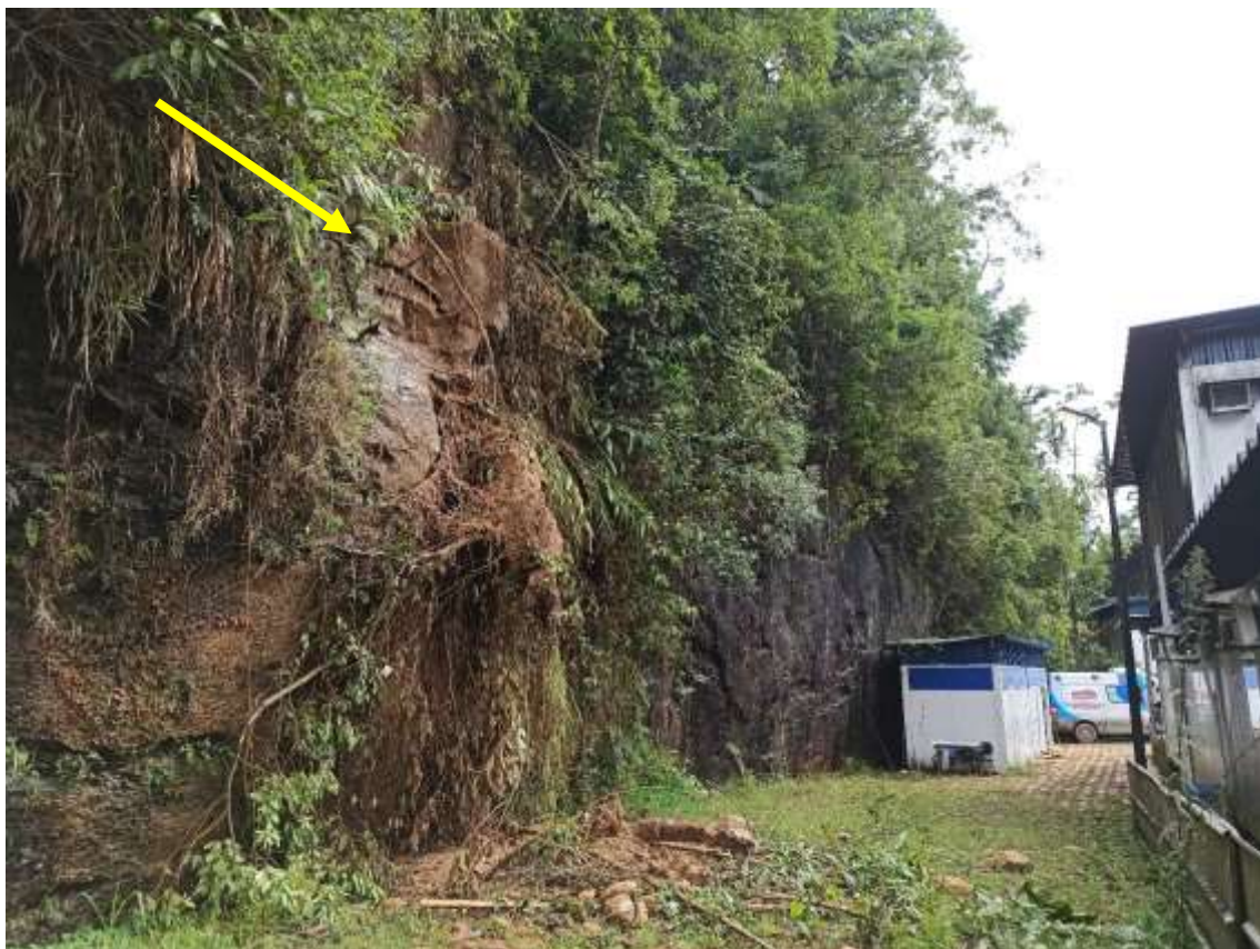
Figura 2. Risco de desprendimento de bloco, ameaçando se deslocar em direção aos fundos da UPA Centro.
