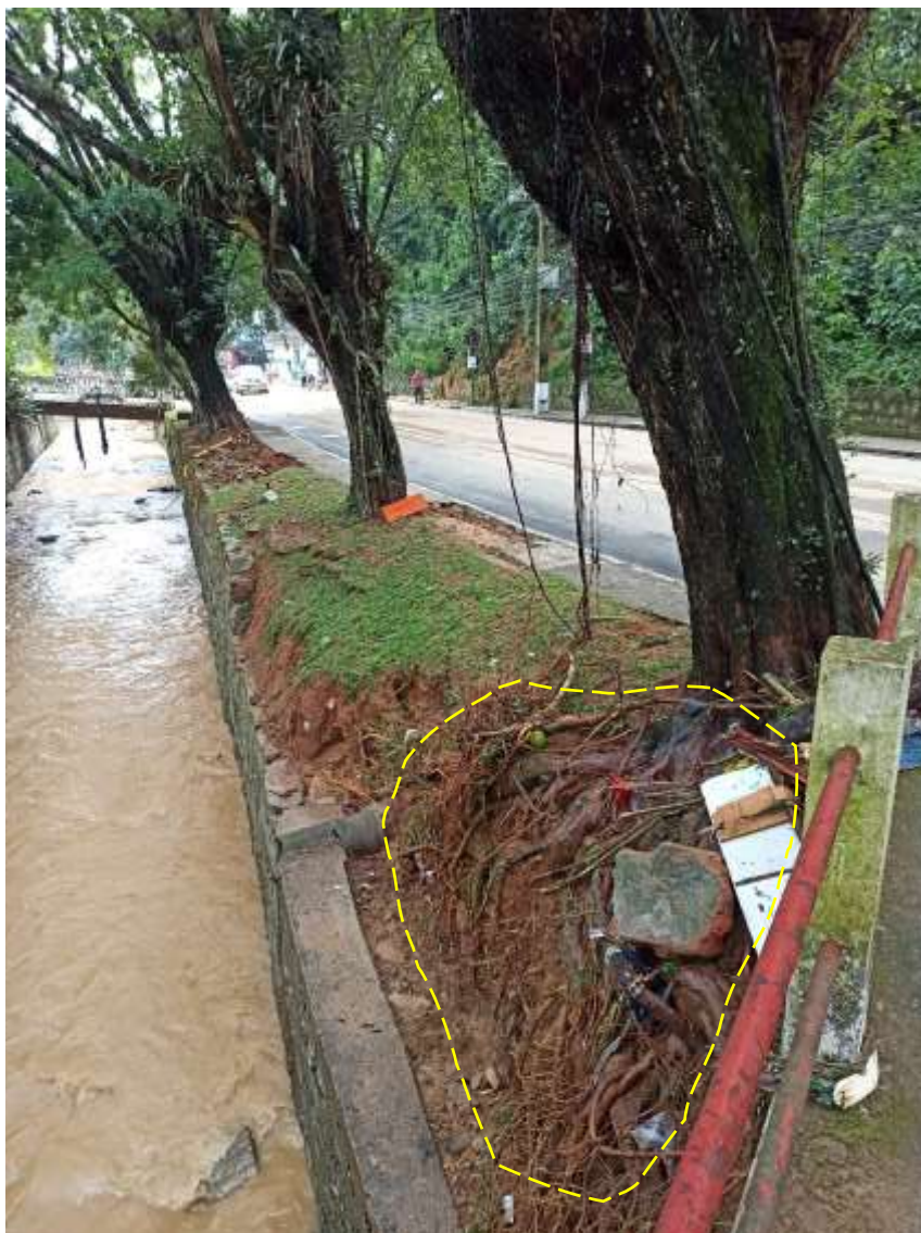
Figura 3. Risco de queda de árvore na frente da UPA.
