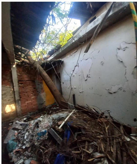
8 - ÁREA EXTERNA COM ENTULHO
