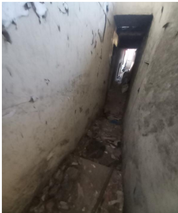
4 - CORREDOR DE ACESSO, SEM ILUMINAÇÃO
