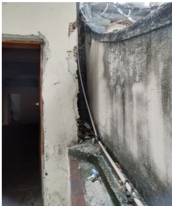
32 - VAO ENTRE A CASA E O MURO
