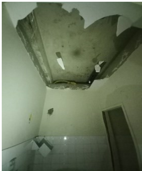
11 - BANHEIRO 1(DETALHE NO TETO)
