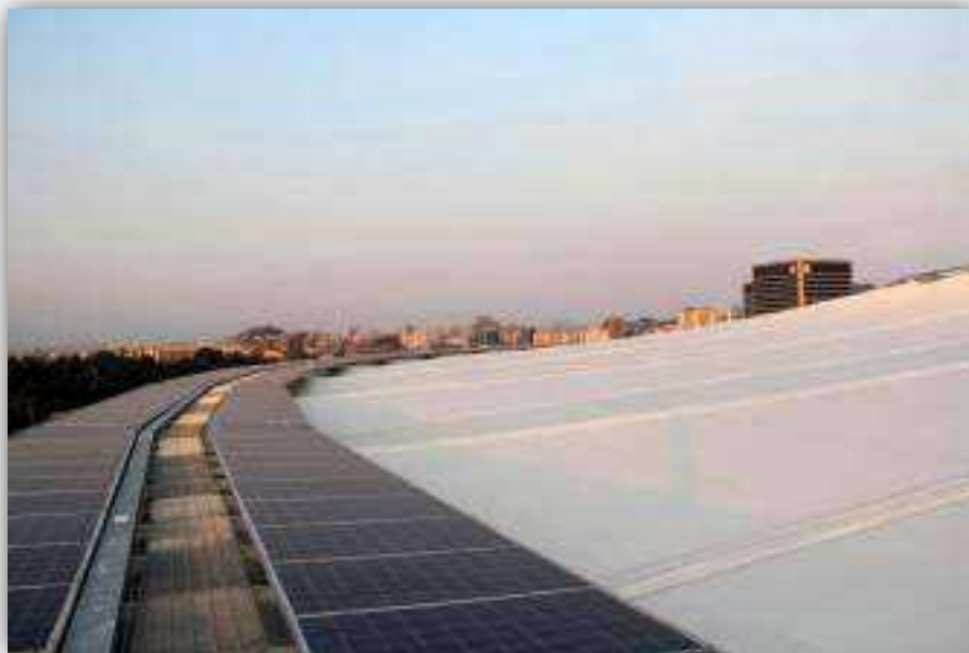
Figura 62: Parte da Usina Solar no teto do Estádio Maracanã
