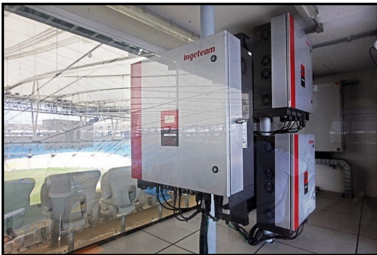
Figura 68: Inversora responsável pela inversão da energia contínua em corrente alternada (localizada no Nível 5, Pilares 23 e 38)
